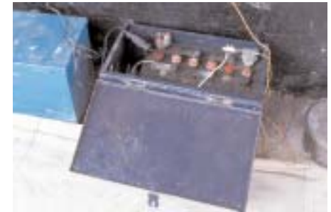
Die Batterie muss im wärmsten Raum aufgestellt sein
