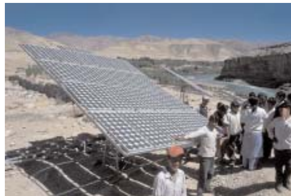
Große Photovoltaikanlage bei der SECMOL - Schule
