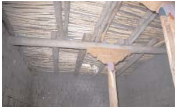
Verlegung der Deckenbalken und Steher, hier von innen mit Abdeckung durch entrindete Zweige.
