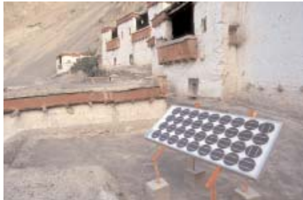
Photovoltaikanlage im Kloster Rizong
