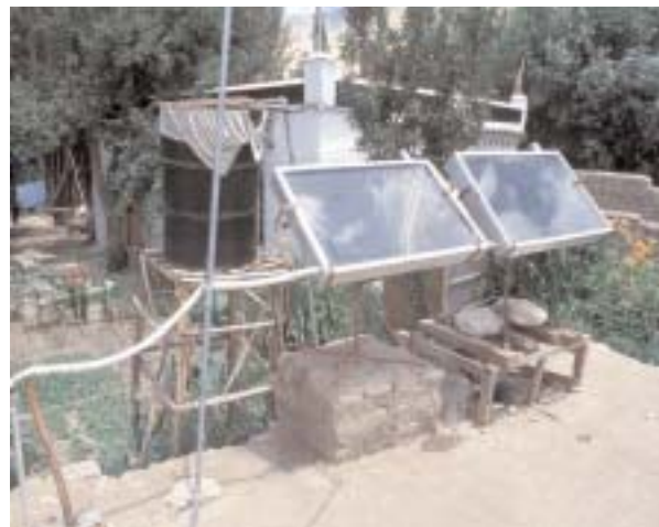
Ideale Anwendung der Solaren Warmwasserbereitung bei einem Hotel
